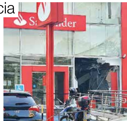
Parte da agência do Santander ficou destruída
